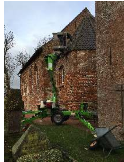
Handwerker reparieren von einer Hebebühne aus das Dach der St. Jodocus-Kirche. Foto: Heinz Martin
